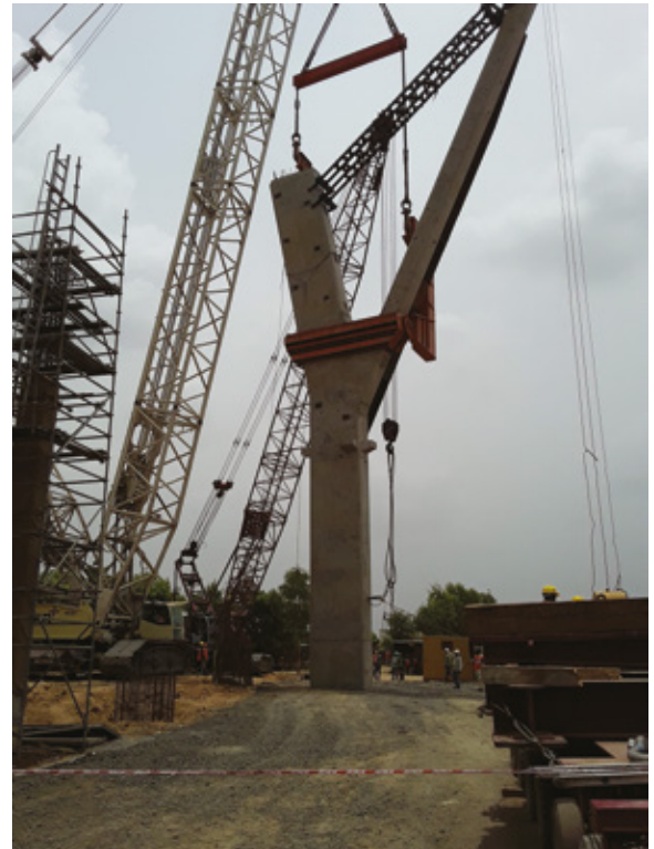
Figura 10: Vista de una columna HY después del montaje. Durante la operación, la columna fue reforzada por una armadura entre ambos brazos.
