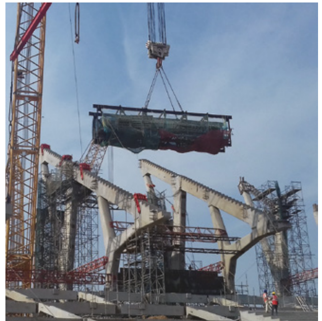
Fig. 13: Colocación de una viga circunferencia de concreto en el lugar. La viga está encerrada en un conjunto de armadura medida para permitir la terminación segura de las conexiones coladas en el sitio a los marcos radiales.
