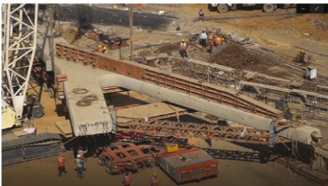
Figura 8: Una columna prefabricada es transportada al punto de montaje usando un trailer. Las piernas largas y delgadas de cada unidad de las columnas prefabricadas necesita apoyos fuertes, así como tensores para su montaje.
