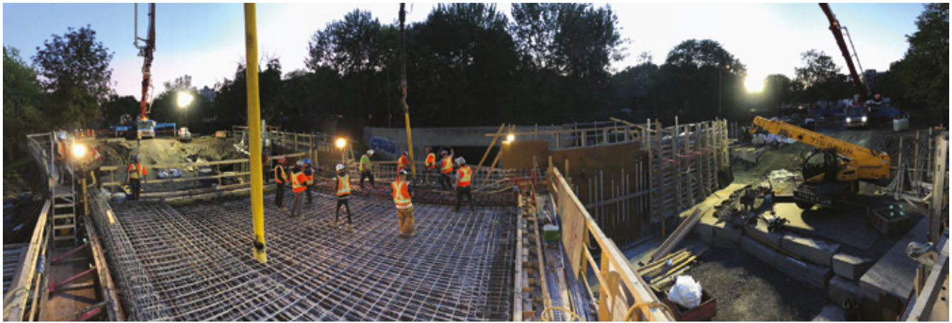
Fig. 12: Uno de los dos puentes que se están construyendo en Montreal, compuesto de concreto con 10% de cemento en sustitución con PVM Tipo GS. Los puentes serán instrumentados y supervisados a detalle por la Universidad de Sherbrooke y el Ayuntamiento de Montreal (foto cortesía del Ayuntamiento de Montreal)
