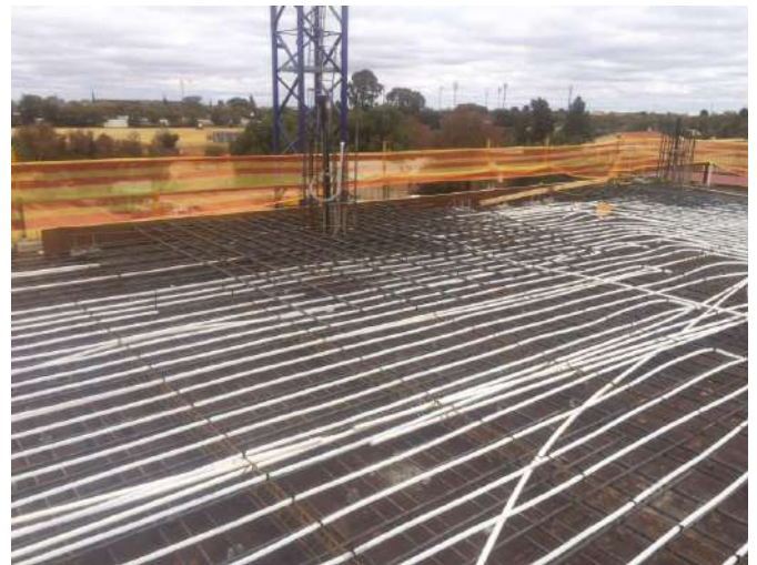
Figura.7: Se instaló un sistema de construcción activado térmicamente (TABS, por sus siglas en inglés) en los pisos de la losa de concreto y en el techo para proporcionar calefacción y refrigeración al edificio
