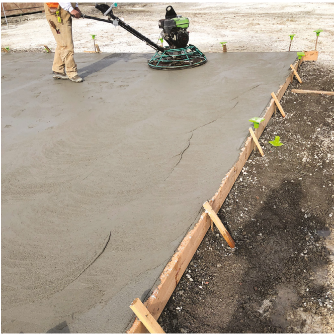
Figura. 5: Después de la flotación del canal y el tiempo de espera, los trabajadores usaron una allanadora mecánica de tipo helicóptero de 36 in (914 mm) con una bandeja
