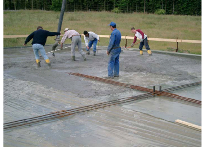
Figura 4: Losa elevada de SFRC construida con concreto fluido. Diseñada según el método descrito en el reporte ACI 544.6R-15, esta losa incluye un refuerzo de integridad -varillas de refuerzo inferiores que se extienden de columna en columna- para evitar el colapso progresivo en caso de sobrecarga o daños
