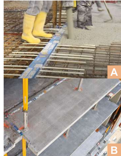
Fig. 3: Roturas de puente térmico estructurales en balcones: (a) durante la colocación del concreto del balcón, y (b) después de la colocación del concreto del balcón y de la losa. Nota: Los módulos se instalan con la placa superior al ras de la estructura exterior de concreto. Las barras blancas son barras de GFRP.
