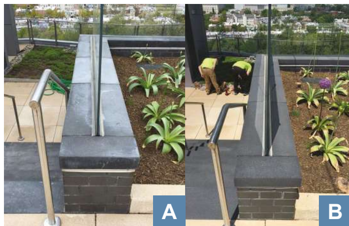
Fig. 5: Los adoquines de piedra colada sirven como remate en un muro de mampostería: (a) la eflorescencia disminuyó la apariencia del muro; y (b) la limpieza final expuso el verdadero color de los adoquines.
