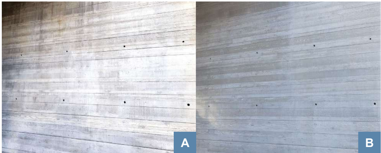
Fig. 1: Acabado formado por un tablero: (a) tal como está construido; y (b) la misma superficie después de quitar las manchas y limpiar.
