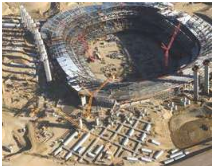
Fig. 3: Vista aérea de la construcción del Estadio SoFi. El patrón en forma de rejilla visible en el primer plano está compuesto por puntales que anclan las columnas tipo hoja al suelo fuera de la zona de relleno del MSE.
