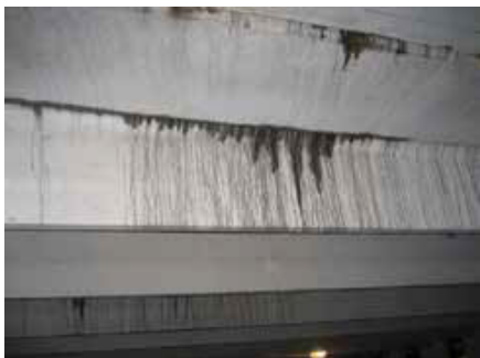
Fig.2: Manchas de agua en un borde agrietado en la Estructura B
