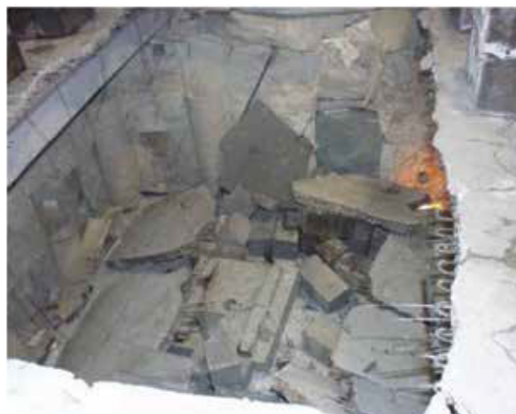
Fig. B: Foto de la pág. B-3 de la referencia 19. El título original dice: "Carga colapsada a los 3 minutos y 55 segundos después de que finaliza la exposición al fuego"
