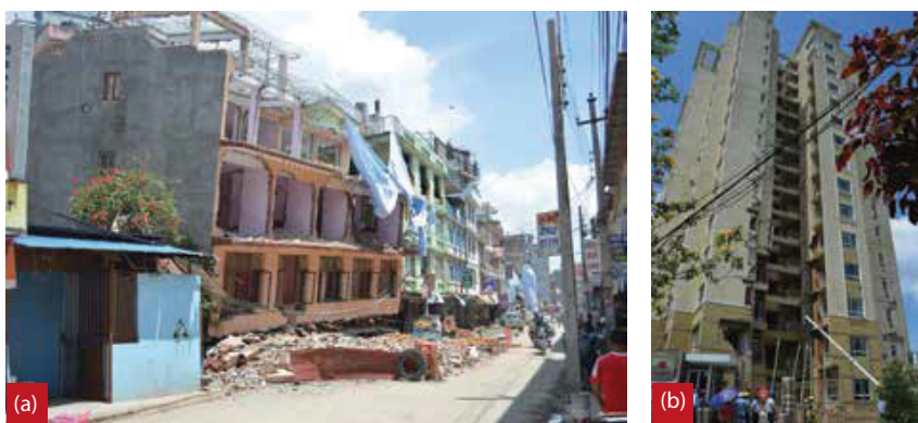
Fig. 3: Edificios dañados en el terremoto de Nepal de 2015: (a) edificio de poca altura (después de la Referencia 18, con licencia CC BY-SA 3.0); y (b) edificio de gran altura (después de la Referencia 19, con licencia CC BY-SA 3.0)
