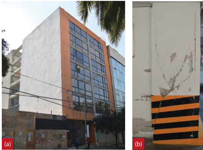
Fig. 6: Un edificio residencial típico afectado por el terremoto de Puebla de 2017: (a) los marcos de borde orientados perpendicularmente a la calle tenían muros de relleno continuos y no presentaban daños significativos; y (b) los marcos de borde orientados paralelos a la calle tenían muros de relleno y fenestración y exhibían fallas por corte en las columnas del primer piso (después de la Referencia 26, con licencia CC BY-NC-SA 4.0)
