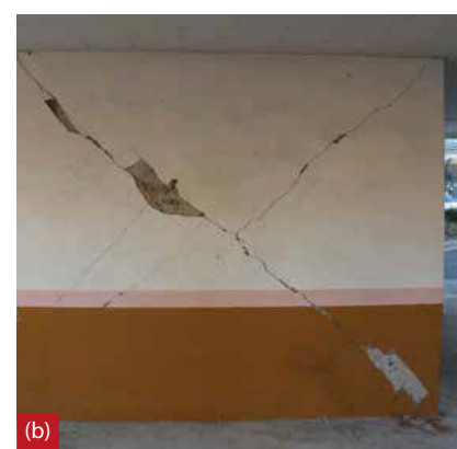
Fig. 7: Daño observado a las estructuras de RC en el terremoto de Pohang de 2017: (a) una columna del primer piso; y (b) un muro estructural en otro edificio (después de la Referencia 28, con licencia CC BY 3.0)
