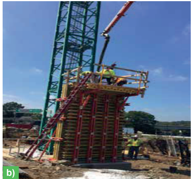
Fig. 16: Se utilizaron maquetas para evaluar los métodos de colocación: (a) bombeo en la base del encofrado; y (b) usar la manguera de la bomba de concreto como un conducto de caída
