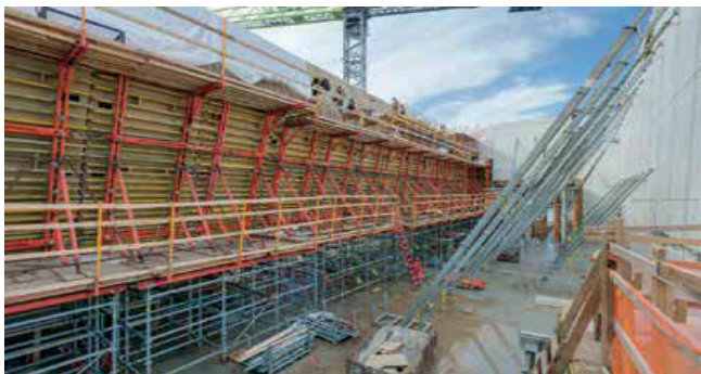
Fig.11: Vista de la cimbra interior y el encofrado necesarios para construir el muro curvo del River Pavilion.
