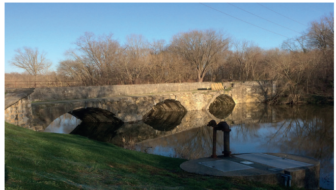
Acueducto Conococheague antes de la reparación
