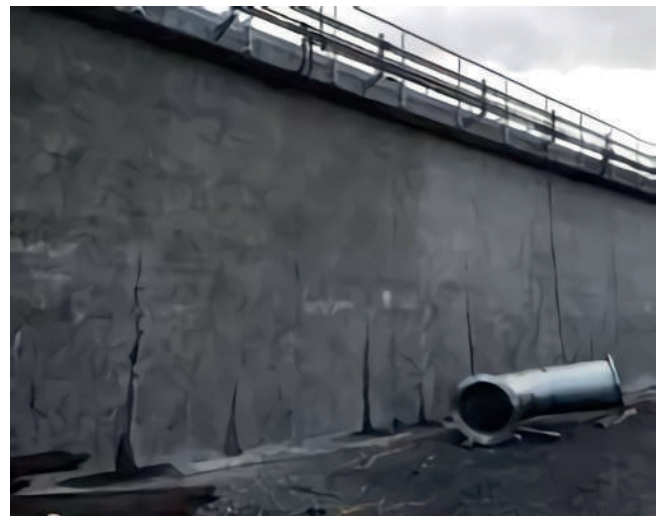
Fig.3: Agrietamiento vertical de la pared resultado de la restricción de la base de concreto por cambios en volumen de T&C.
