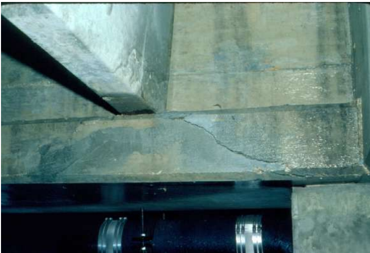
Figura. 1: Una forma típica de peligro en la plataforma
