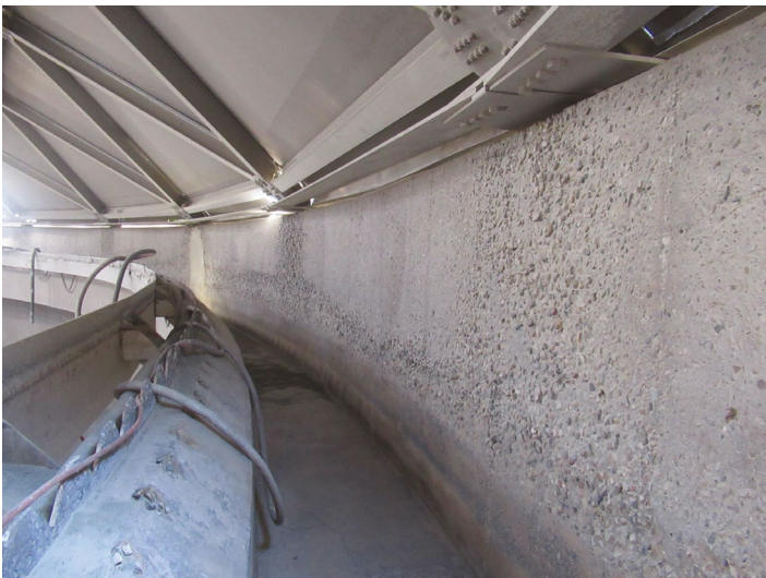
Fig. 1: Pérdida de superficie de concreto con áridos expuestos por contacto con ácidos en una planta de tratamiento de agua (foto cortesía de Wiss, Janney, Elstner Associates, Inc.).
