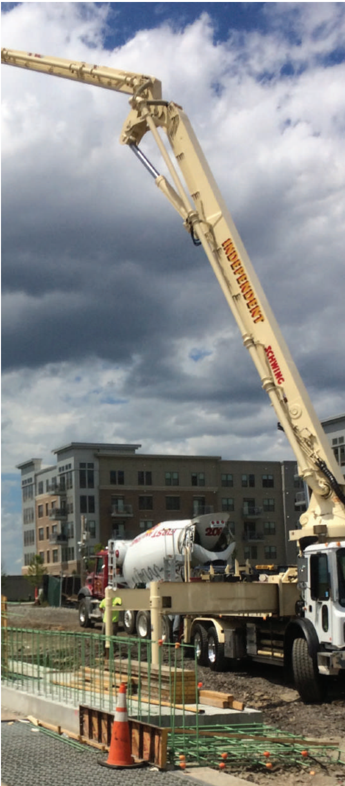
Casi todo el concreto ligero usado en losas elevadas es bombeado (foto cortesía de William H. Wolfe)
