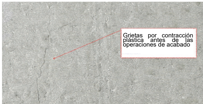
Fig. 1: Grietas por contracción plástica antes de las operaciones de acabado.
