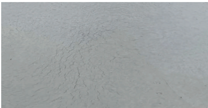
Fig. 3: Grietas en la superficie durante la operación de allanado, el concreto debajo de la superficie todavía es plástico.
