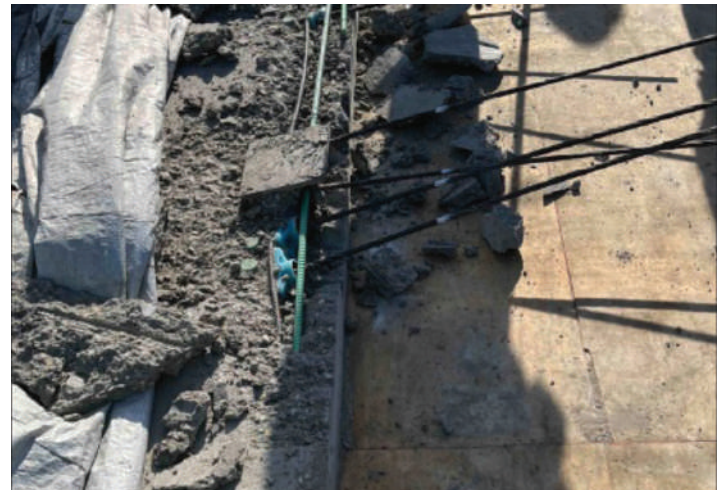
Fig. 12: Los tendones de una losa de concreto construida con concreto Tipo IL se tensionaron basándose en una calibración de madurez para concreto de cemento Tipo I. Se sobrestimó la resistencia del hormigón de cemento Tipo IL, lo que provocó reventamientos en las losas.
