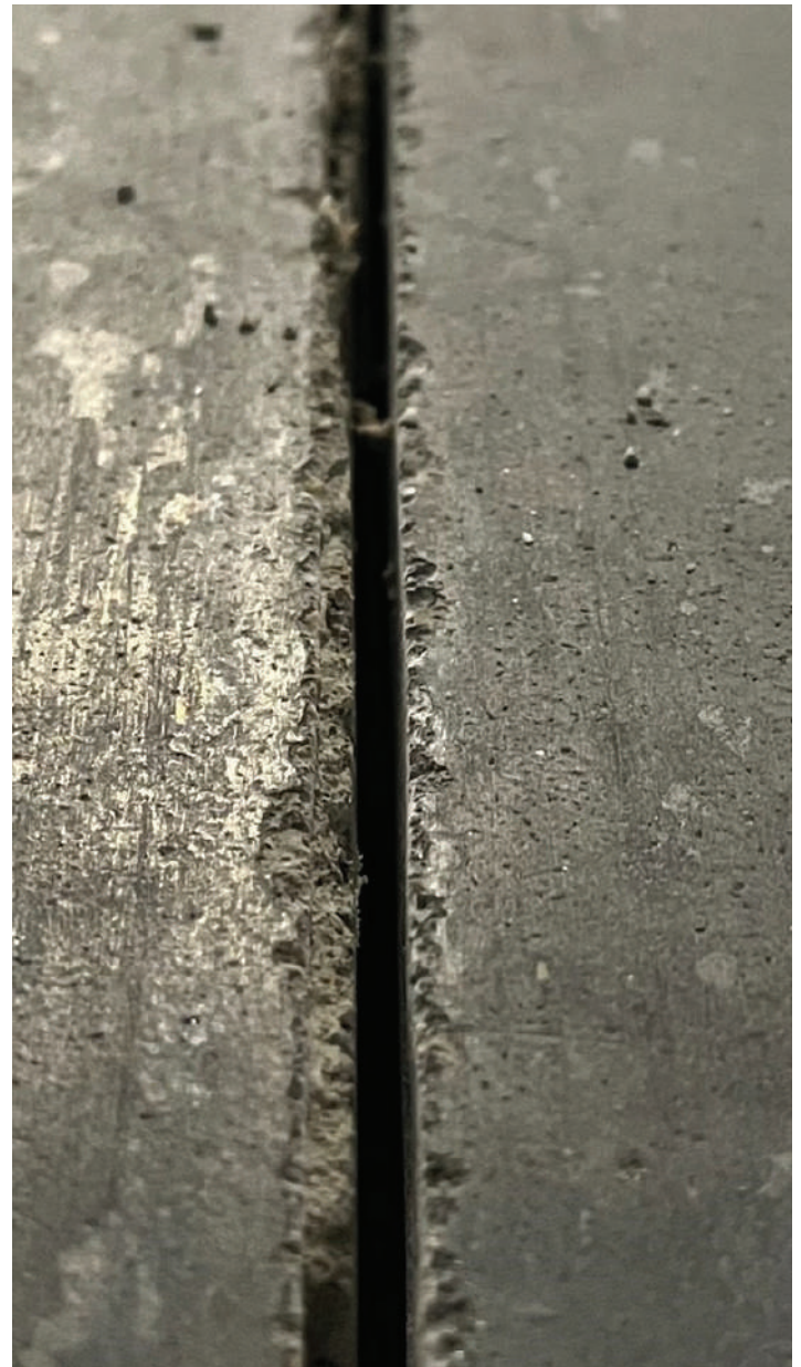
Fig. 9: El corte demasiado temprano produce bordes de las juntas desmoronamientos (fotografía cortesía de Scott Metzger, Metzger/McGuire).
