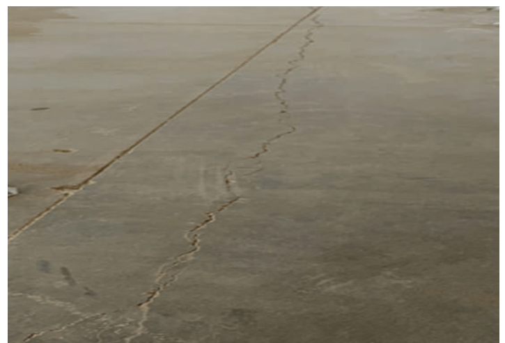
Fig. 10: El corte con sierra demasiado tarde produce grietas (fotografía cortesía de Scott Metzger, Metzger/McGuire).
