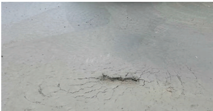
Fig. 2: Desgarro de la superficie durante el allanado.
