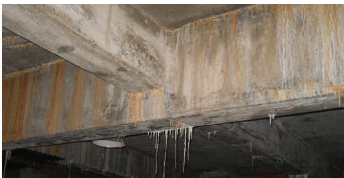
Fig. 1: Filtraciones con manchas de corrosión en una estructura de pórticos de un estacionamiento existente.
