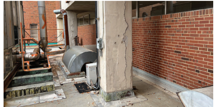
Fig. 3: Grietas verticales y delaminación del concreto en una columna.
