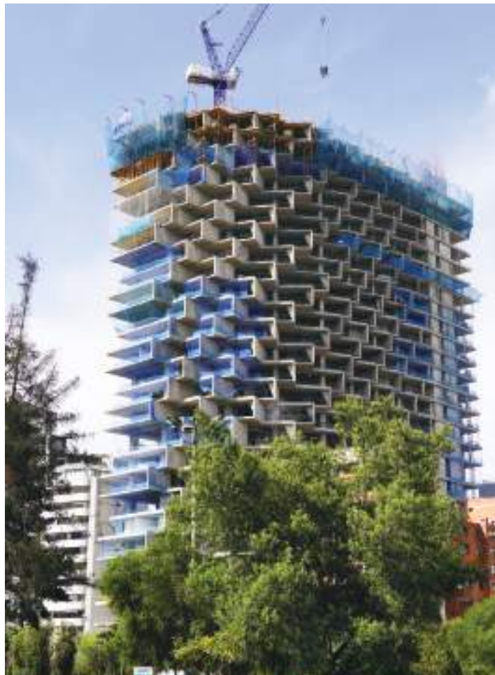
Fig. 6: La grúa de construcción estuvo apoyada en los pisos ya terminados (fotos cortesía de Uribe Schwarzkopf).
