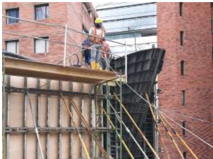
Fig. 7: El encofrado de acero se reutilizó para construir las jardineras de las terrazas (foto cortesía de Fernando Romo Consultores).
