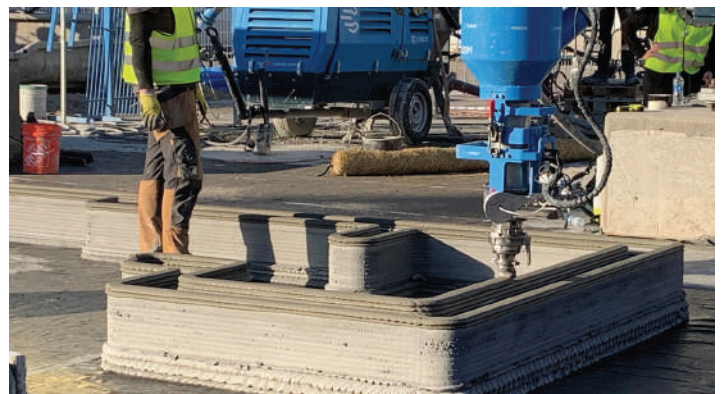
Demostración de impresión 3-D en World of Concrete, Las Vegas, NV, Estados Unidos de Norteamérica
