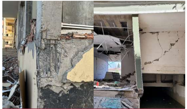
Fig. 4: Falla de una columna (izquierda) y de un muro estructural (derecha) sin confinamiento adecuado dentro de la cimentación cerca de un borde, Turquía, 2023
