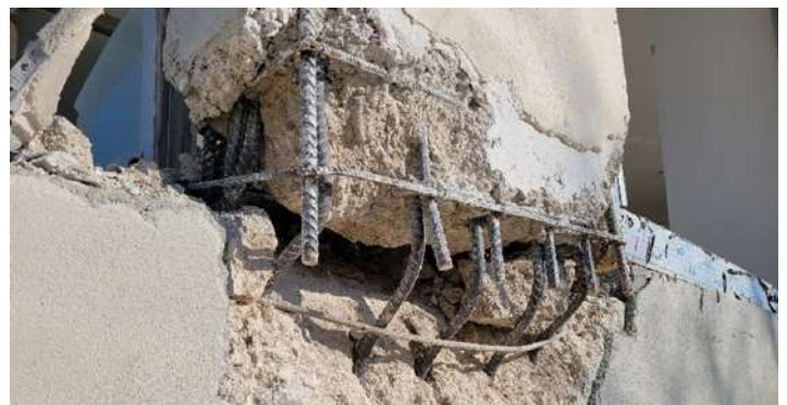
Fig. 5: Falla de una columna sin confinamiento adecuado dentro de la cimentación cerca de un borde y empalmes por traslape inmediatamente arriba de la cimentación, Turquía, 2023
