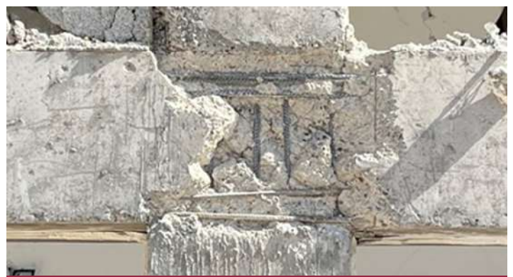
Fig. 6: Nudo viga-columna con el refuerzo de la viga no confinado, Turquía, 2023
