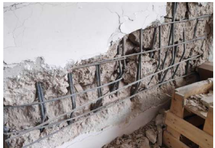
Fig. 3: Falla de un muro con empalmes por traslape del refuerzo vertical corto y sin confinamiento del elemento de borde, Turquía, 2023
